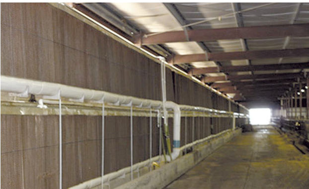
Fotografía 4. Vista interior de pared lateral de entrada de aire compuesta por paneles evaporatorios
