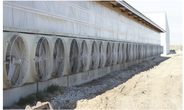
Fotografía 3. Vista exterior de la pared lateral compuesta de ventiladores
